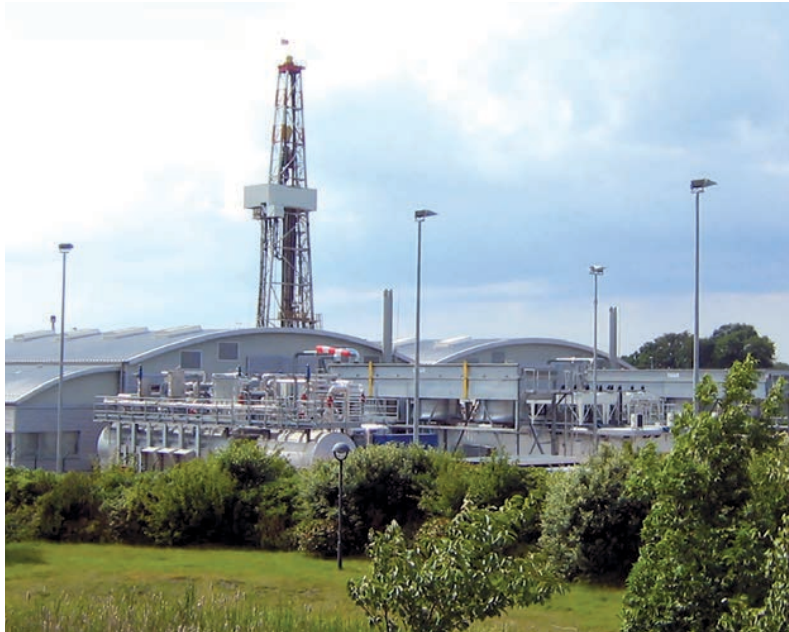
Zentrale Gastrocknungsanlage (ZGTA) der DEA Deutsche Erdoel AG in Völkersen
