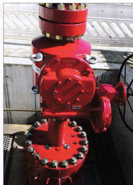
Abb. 6 Hartmann Wellhead der Produktionsbohrung Freiham mit zwei Kabeldurchführungen sowie weiteren Anschlüssen am Pack-Off-Flansch
