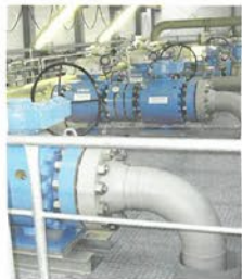
Sperrstrecken bei der Gastrocknung erleichtern Instandhaltungsarbeiten. Quelle: Hartmann Valves
