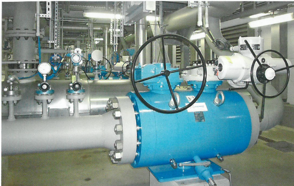
Die Twin-Ball-Valve-Sperrstrecke in der Gastrocknung des DEA-Erdgasspeichers in Wolfersberg ist besonders platzsparend
