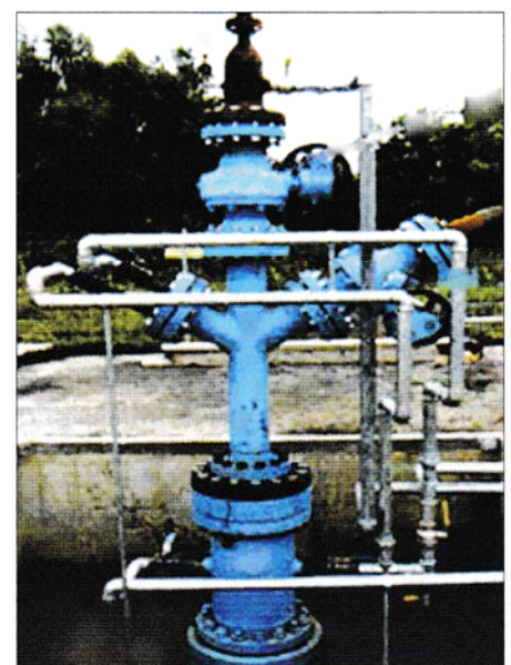
Abb. 4 Die ersten Komponenten des Bohrlochkopfes in Bruchsal wurden bereits in den 1980ern installiert
