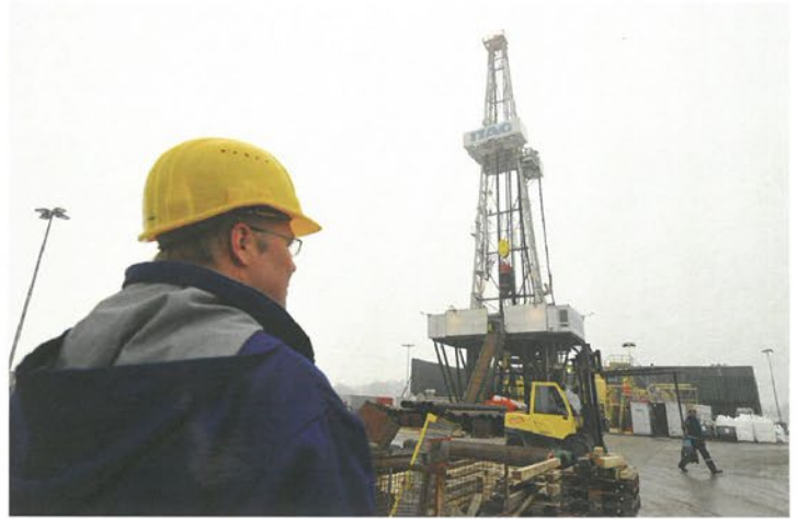
Das Areal von Jemgum wurde als Gasspeicherort gewählt, weil es durch die unterirdischen Salzstöcke für die Speicherung von Erdgas besonders gut geeignet ist. Quelle: Erdgasspeicher Jemgum
