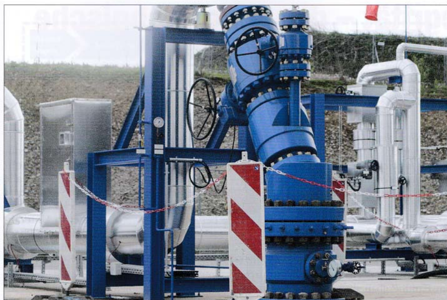
Abb. 5 Hartmann Bohrlochkopf der Injektionsbohrung in Traunreut bei München
