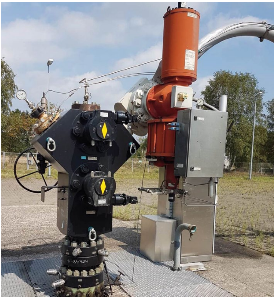
Abb. 1 Erfolgreicher Umstieg: Das E-Kreuz mit Kugelhähnen und Schnellschlussarmatur ist nahezu wartungsfrei in der Gasproduktion im Einsatz
