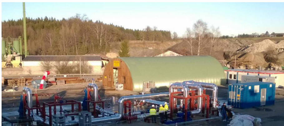
Blick auf die Bohrungsdublette mit den beiden Kopfverflansungen links im Bild.
